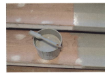
De to hovedtrapper på Augustenborg Slot har fået en tilhørende renovering. Farvekonserver Anne Simonsen kunne finde frem til den oprindelige grå, og sammen med malermester Andreas Nielsen fandt hun frem til en vildgængende ny udgave af den gul farve. Helt tredje rummet har fået en flot indramning med grå og sorte nuancer.
