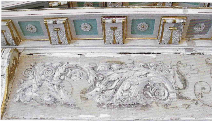
17. Lagvis afdækning af dekorationslagene på dørstykkerne. Til højre i billedet ses den ældste empiredekoration med lyremotiv fra 1807-1808. Til venstre ses en senempiredekoration fra omkring 1820'erne i grisaille teknik. Foto Anne Jonstrup Simonsen.
